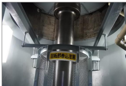
■水力発電所 高速で回転するシャフト
